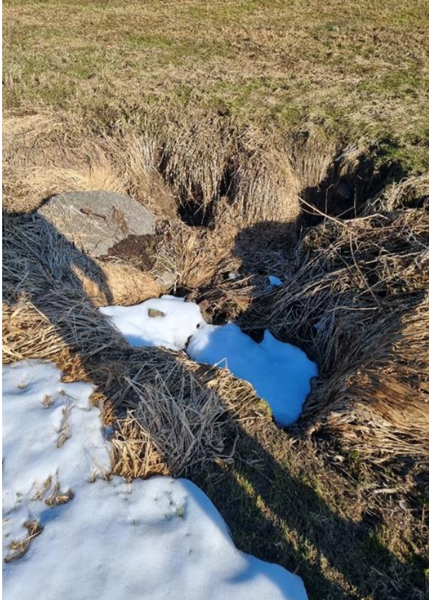
Kollaps i rørsystem og kum
